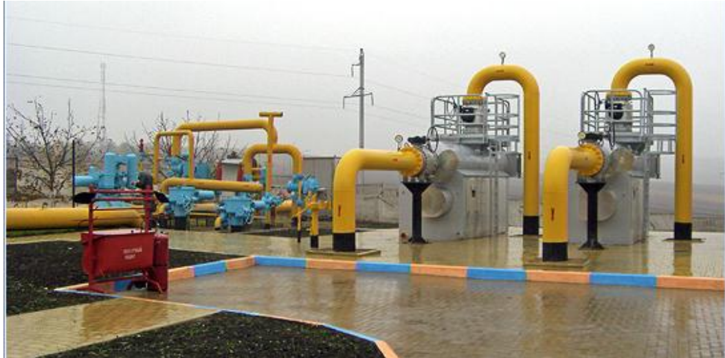
Fig. 1.5. Stația de distribuție automatizată a GN nr. 1 „Chișinău”
