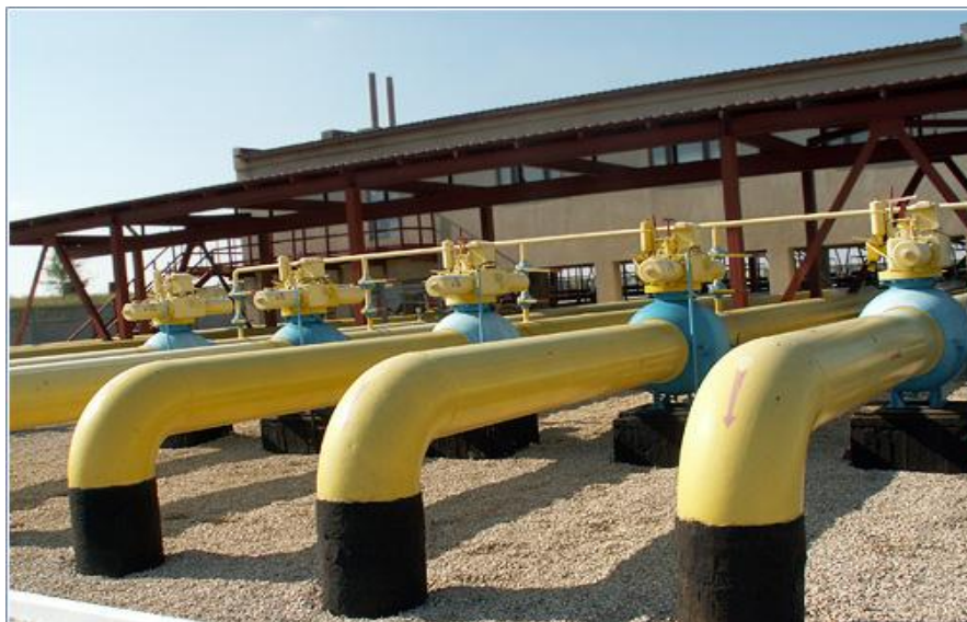
Fig. 1.4. Stația de măsurare a gazelor naturale „Căușeni”
