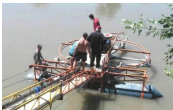
Fig. 28. Prototipul industrial al microhidrocentralei instalată pe râul Prut (comuna Stoieniști, Cantemir, 2009).
