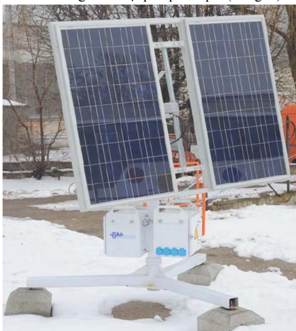
Figura 2. Instalație fotovoltaică cu orientare automată la soare pentru alimentarea cu energie electrică a posturilor antigrindină și pomparea apei
