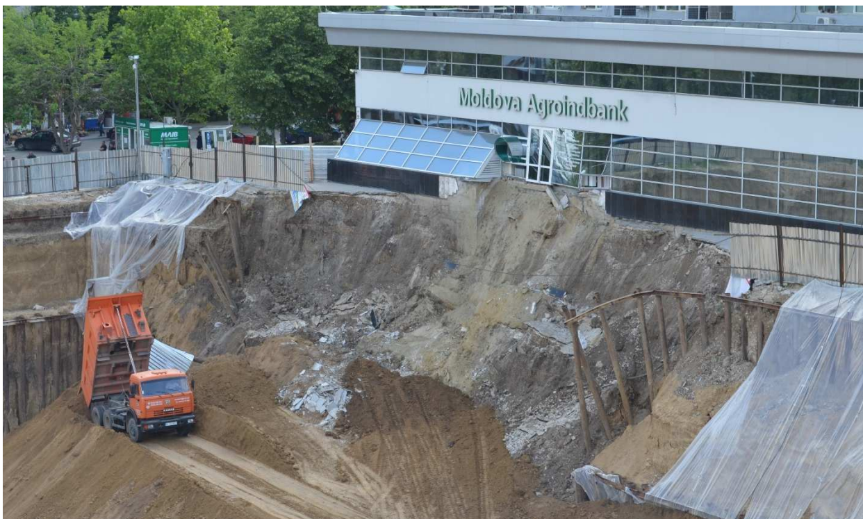
Fig. 4.1. Surparea pereților gropii de fundație executată în pământuri tasabile. Chișinău, str. Miron Costin 9, iunie 2016.
