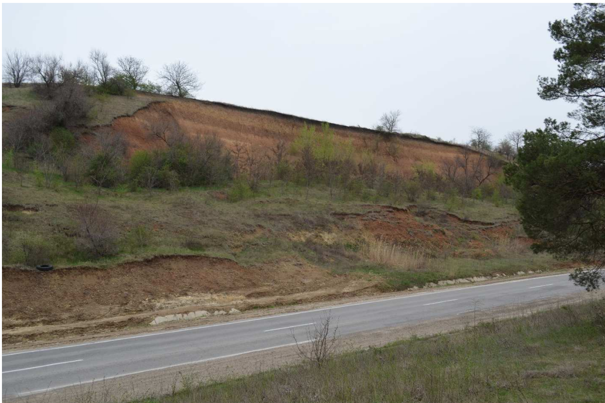
Fig. 4.3. Taluz de debleu supus proceselor de alunecare, pe unul din tronsoanele drumului magistral M21.
