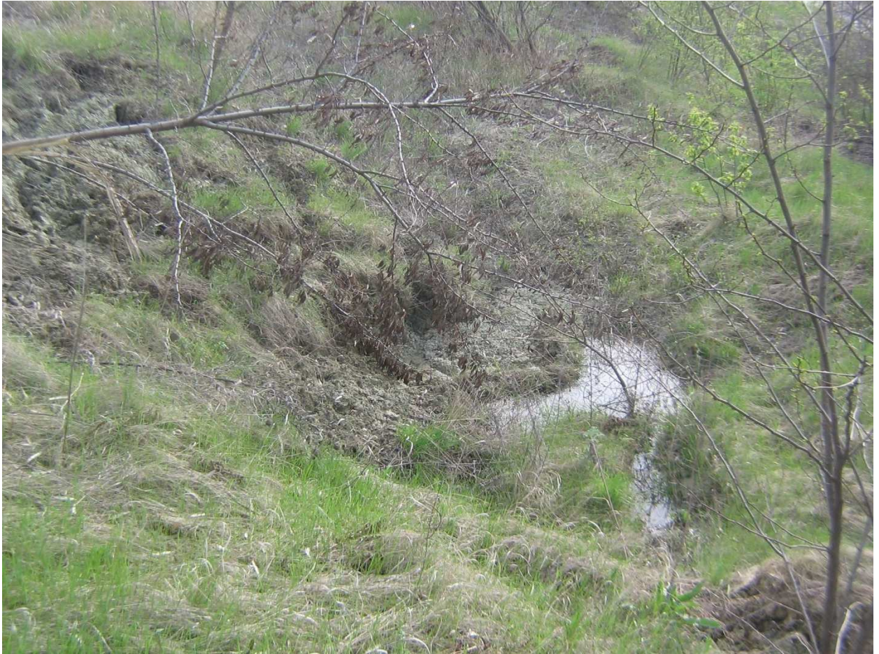
Fig. 3.5 Acumularea apelor provenite din topirea zăpezii pe suprafața debleului în proces de deformare pe tronsonul de drum M21 Chișinău-Dubăsari-Poltava, mai 2016. Sursa: fotografie realizată de autor
