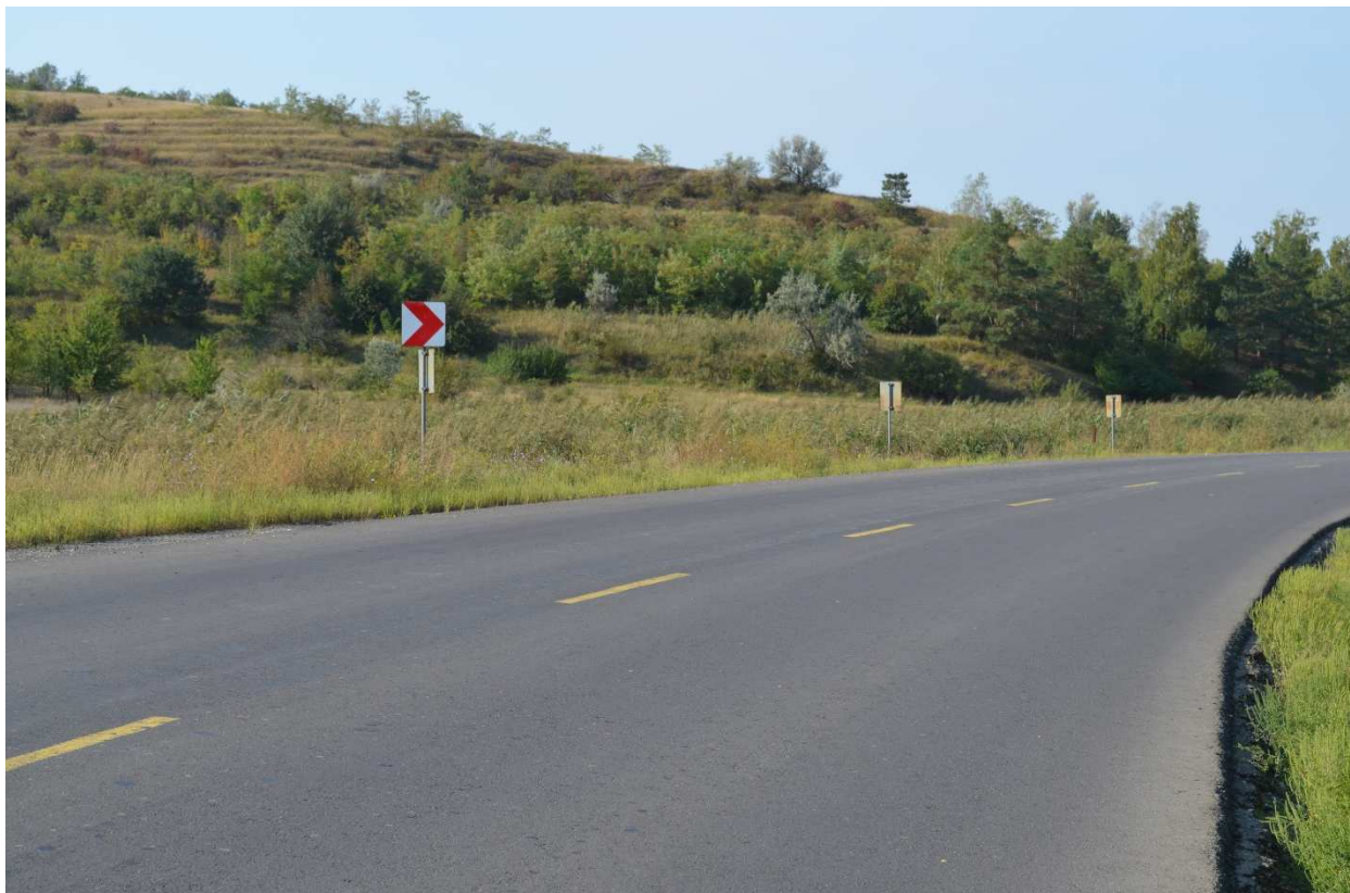
Fig. 3.9 Deformațiile de alunecare pe tronsonul drumului republican R1 Chișinău-Ungheni, km 81+550 (la ieșirea din s. Romanovca). Septembrie 2017
