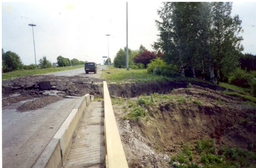
Fig. 3.8 Distrugerea unei porțiuni a rambleului rutier și conului podului a drumului auto Chișinău-Orhei în zona “Răscrucea Orhei”
