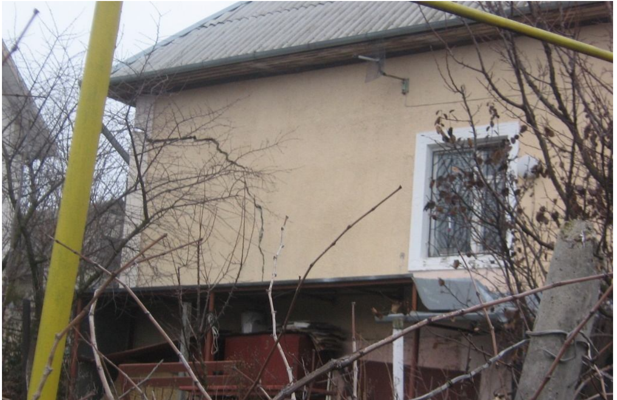
Fig.1.2. Deteriorarea unei case de locuit în urma deformațiilor reologice ale versantului
