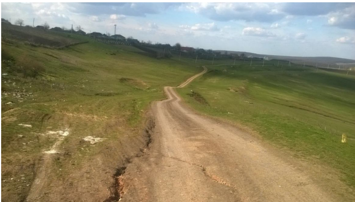
Fig.1.1. Formarea fisurilor pe versantul alunecător
