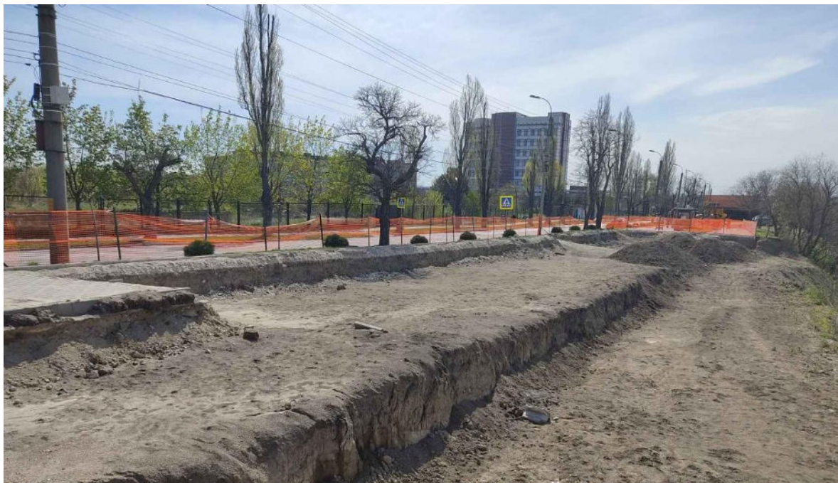
Рисунок 1. Оползневые смещения на смотровой площадке, ул. М. Драган, мун. Кишинэу, 2022 (фото Н. Иким)
