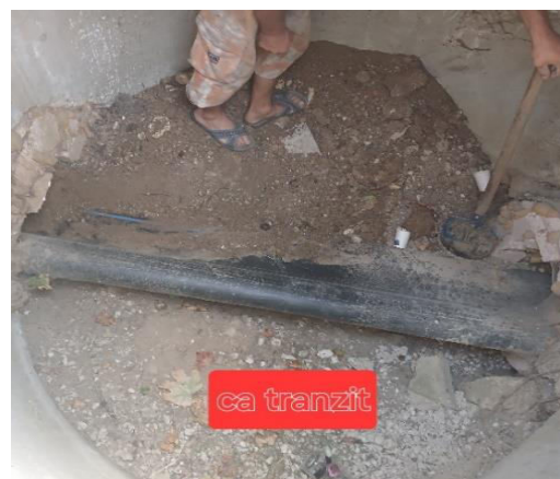
Foto 3. Tub deformat în cămin
