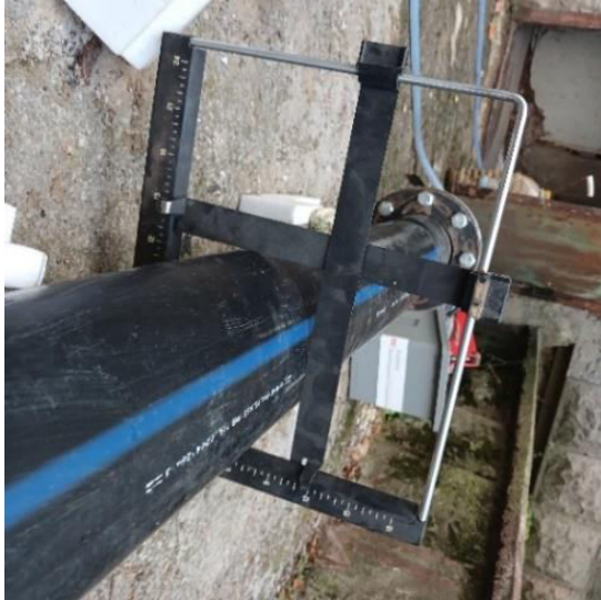
Foto 9. Măsurarea dimensiunilor tubului deformat
