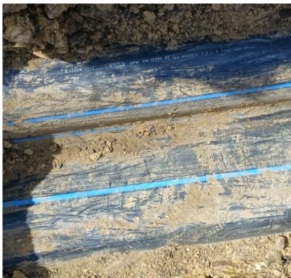
Foto. 5. Tub deformat în săpătură
