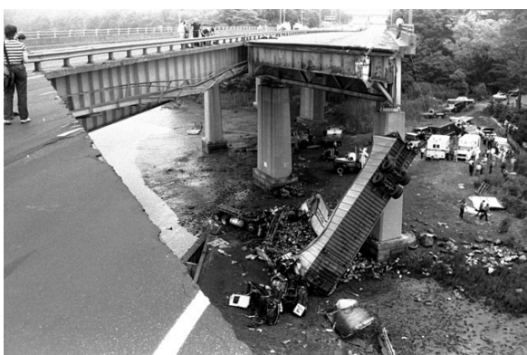
Fig. 1. O secțiune lungă de 100 de metri a podului Interstate 95 care se întinde pe râul Mianus din Greenwich, CT, prăbușit pe 29 iunie 1983 [1]
