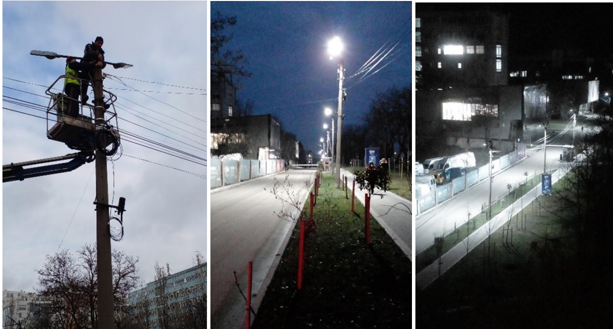
Figura 7. Sistemul nou de iluminat stradal din campusul Râșcani al UTM
