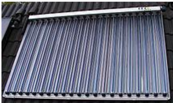
Figura 3. Colectoarele solare cu tuburi vidate
