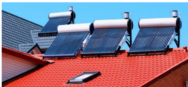
Figura 6. Instalatiile solare orientate spre cer
