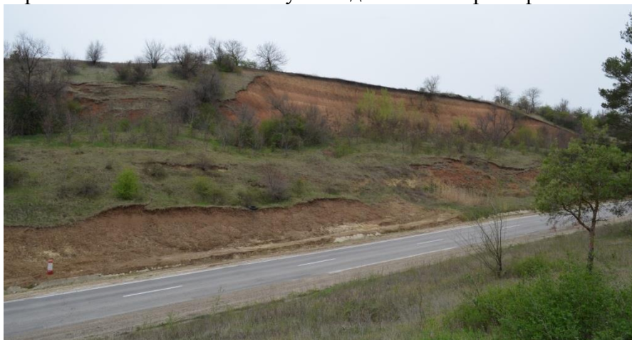
Рисунок 1 – Оползневые процессы вдоль дороги М21, Брест-Кишинев-Полтава
